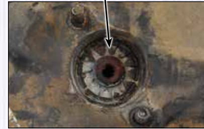
Missing Output Rod
